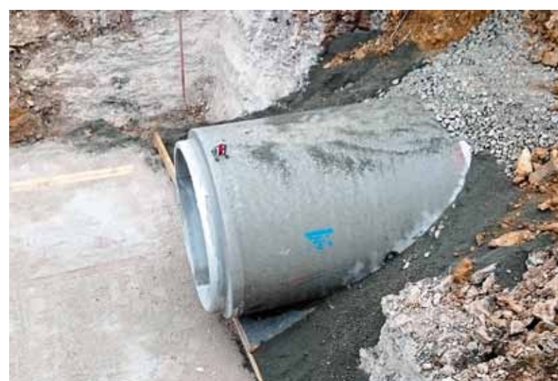
Der Stauraumkanal – bestehend aus FBS-Stahlbetonrohren DN 1400 mit Drachenquerschnitt.
