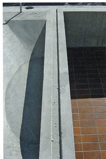
Das monolithische Bodenteil der geteilten Kammern ist werkseitig mit Steinzeug-Platten ausgekleidet
