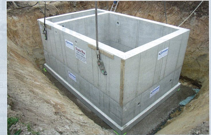
Bild 3: Nach knapp zwei Stunden war der Kompaktschacht kraftschlüssig und wasserdicht wie in „einem Guss“ verbaut
